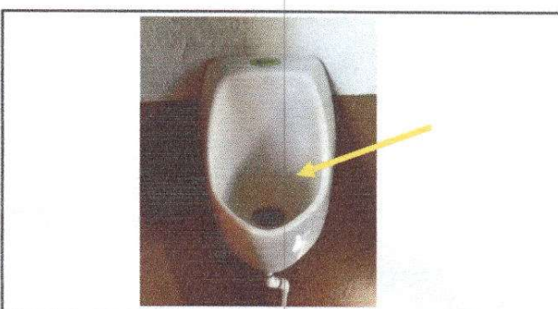
Foto 6: Sustrucción de mingitorio
